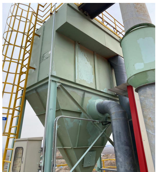
出除泥筛皮带收尘器
