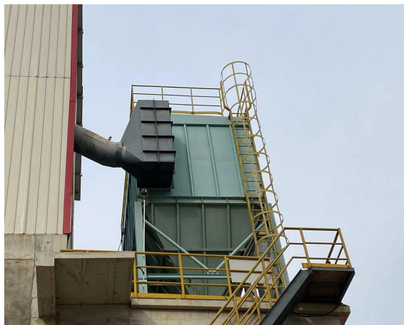
除泥筛分机收尘器
